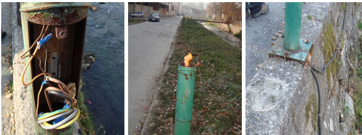
Slika 5 - Uništena, otuđena i neispravna javna rasvjeta, Travnik, prije rekonstrukcije [1]
